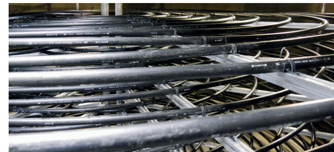
Die Kunststoffleitungen des Wärmetauschers im Eisspeicher unter dem Umweltstations-Parkplatz
