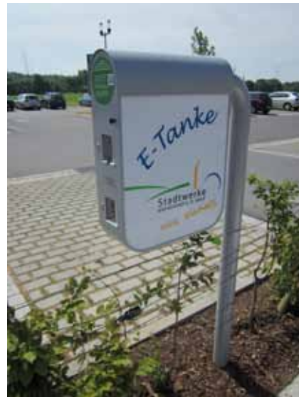
Ladestelle am Busbahnhof Bad Neustadt mit Schuko- und MENNEKES®-Stecker Foto: Alexander Schaub
