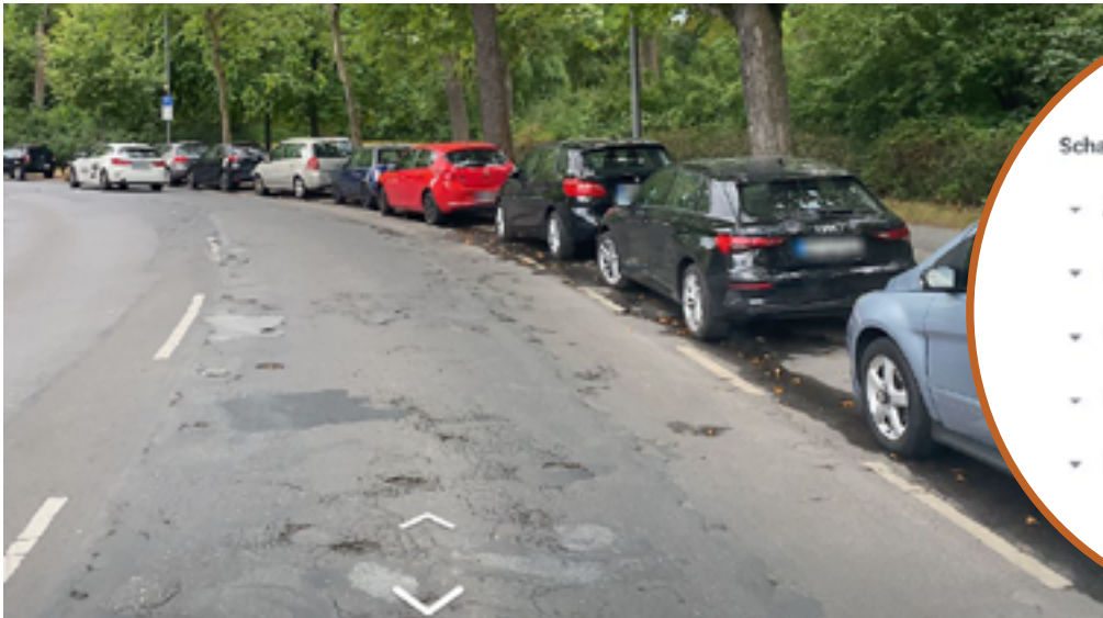
Beispiel Straße in sehr schlechtem Zustand
