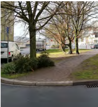
Fehlende Absenkung Bordstein
